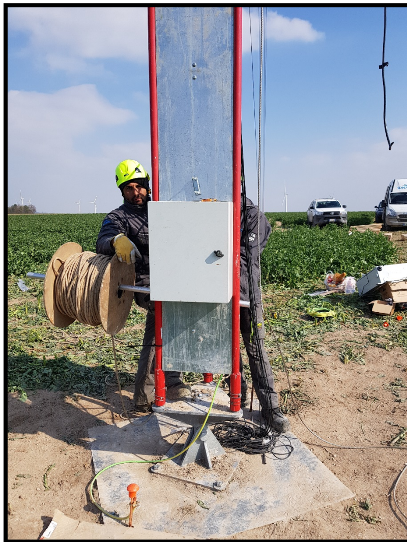
Photo n° 2 : Coffret en place sur le mat de mesure.
